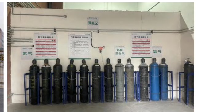
Manajemen ruang penyimpanan tabung gas
