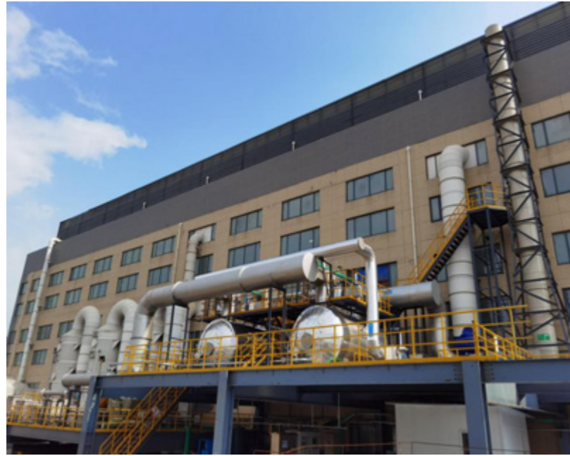
정면 공원의 VOCs 흡착 탈착 장치
