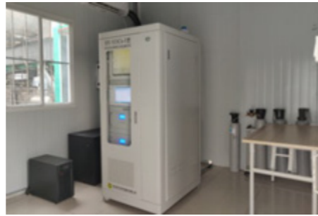
VOCs폐가스 온라인 모니터링 시설
