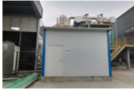
VOCs排気ガス監視室
