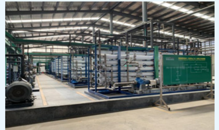
逆浸透膜システム ▶
